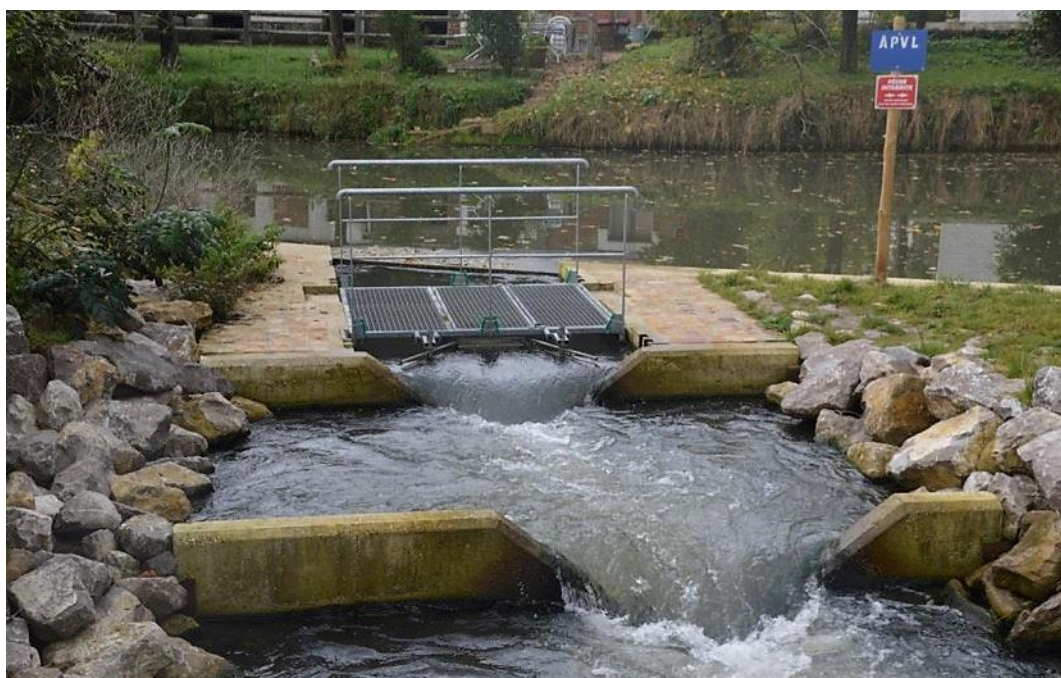
Figure 7: Riverwatcher installé à la sortie de la passe à poissons du barrage de Mourlinghen
