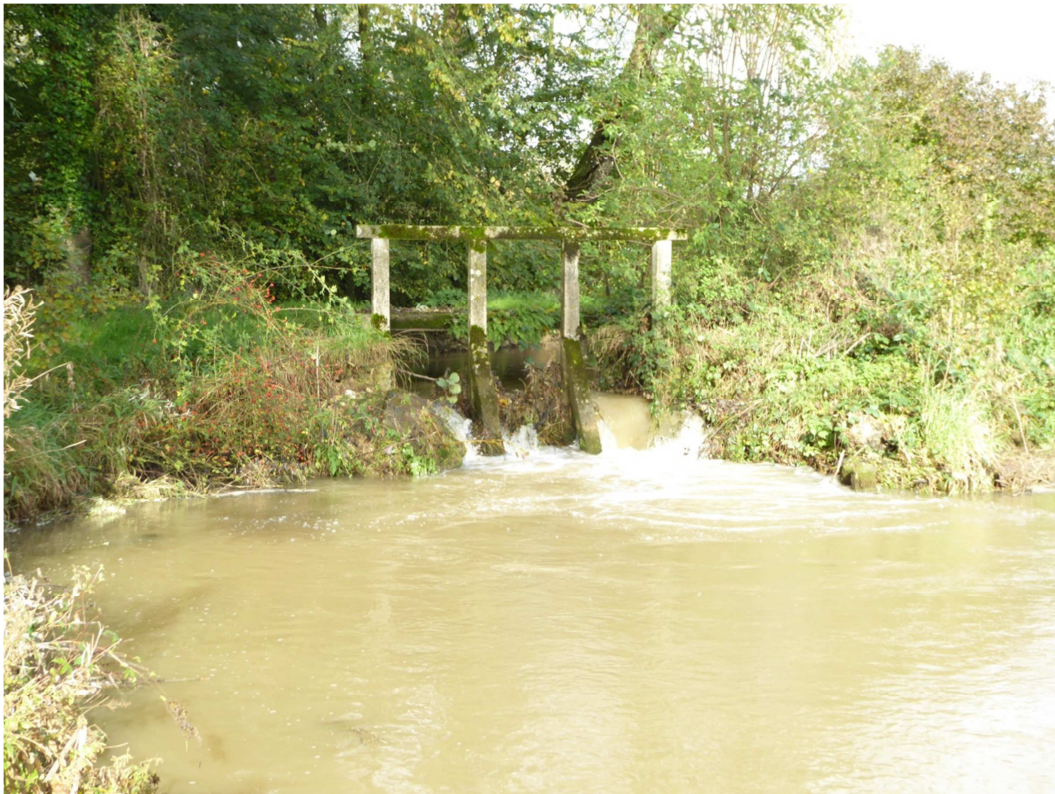
Ouvrage vu par l'aval avec présence d'embâcles
