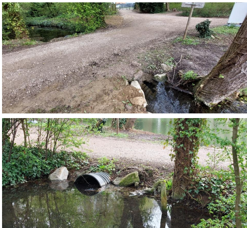
Figure 5 : Buse présente à l'exutoire du chenal des sources en connexion avec l'étang
